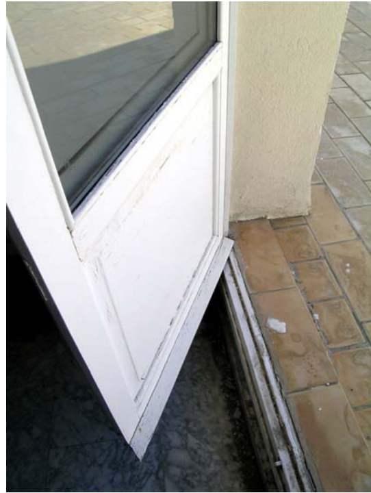
Deterioro carpintería y situación del alfézar sobre carpintería
