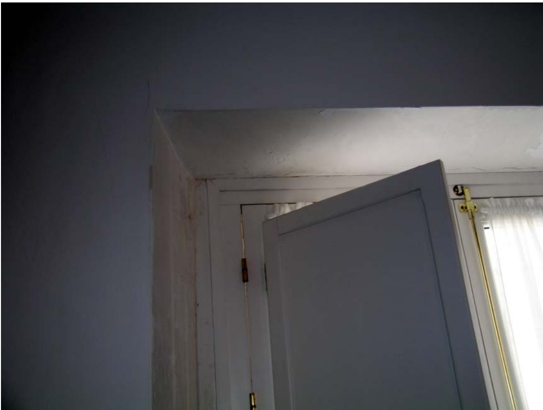
Humedad en el interior de las viviendas por falta de sellado de la unión carpintería-fábrica.
