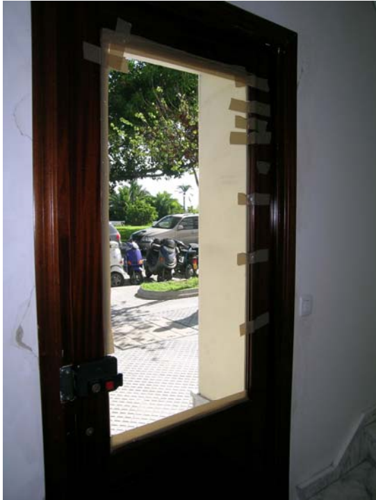
Puerta de entrada al edificio remendada
