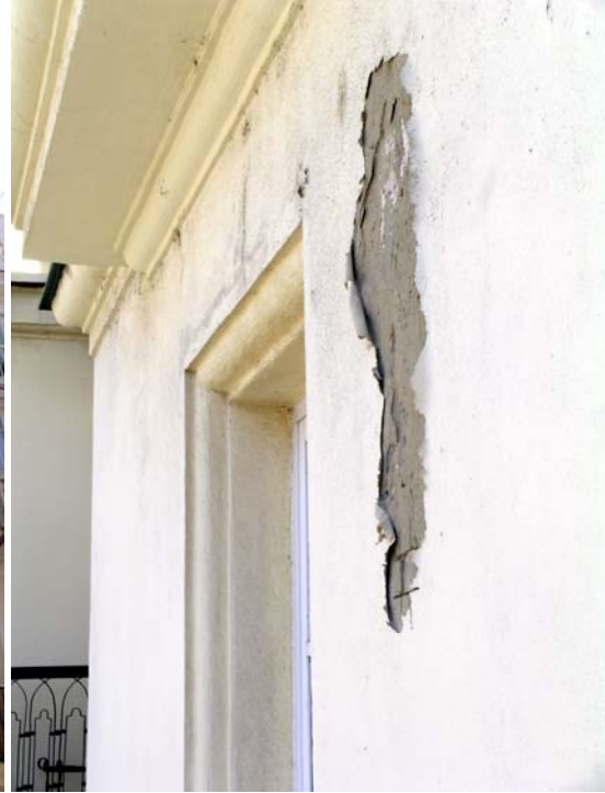
Deterioro de fachada en planta tercera
