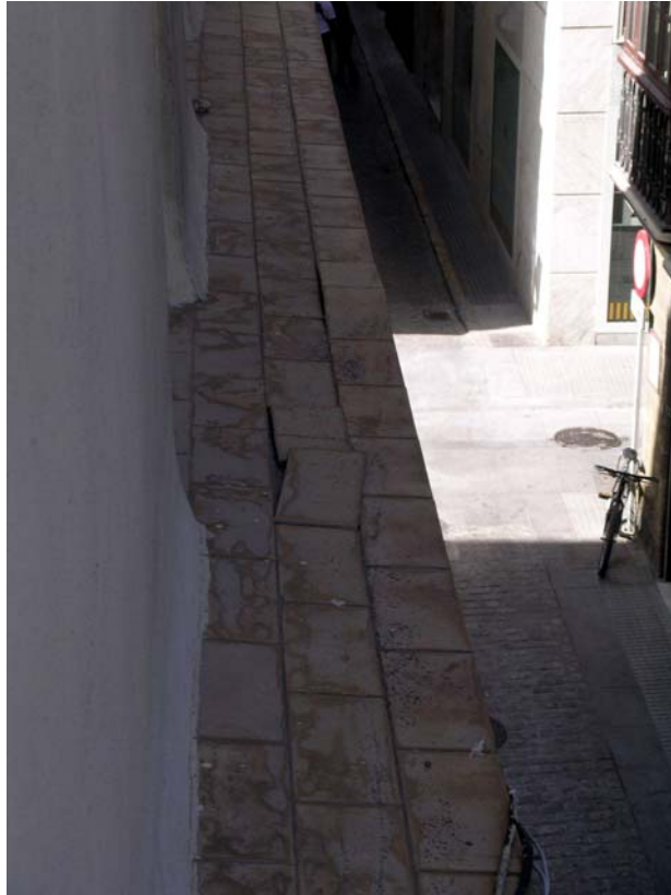
Cornisa intermedia con baldosas sueltas.
